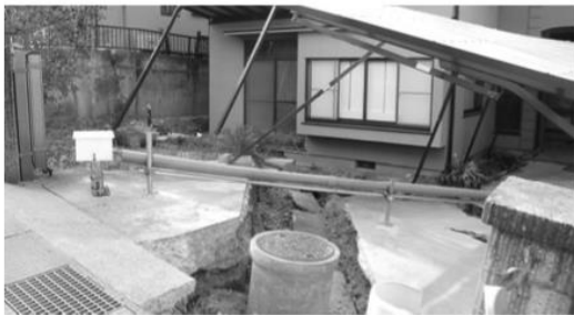
写真2 仙台市緑ヶ丘の住宅地内の地すべり亀裂
