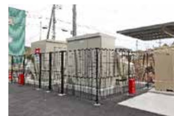
非常用電源設備
