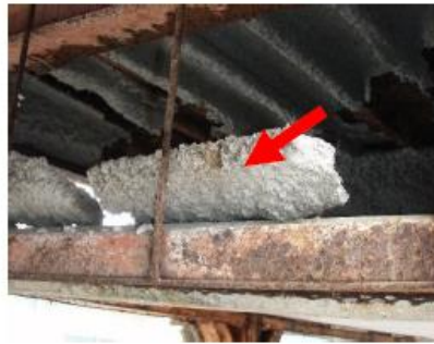
落下した吹付け材
