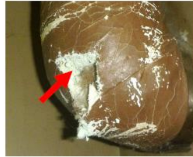
保温材の露出
