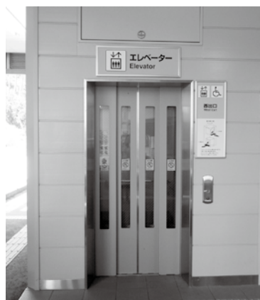
黒江駅に設置されたエレベーター
