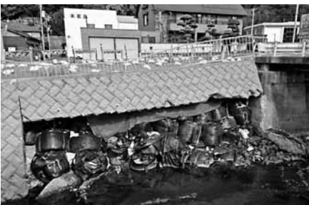
台風の豪雨により崩落した護岸（共栄橋付近）
