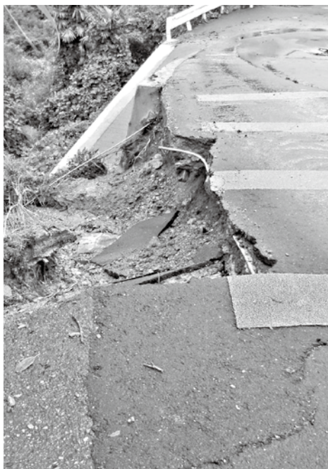
道路の一部が崩落したひや水4号線
