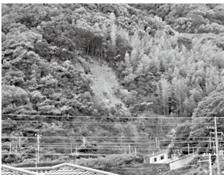
冷水地区の崖崩れ現場
