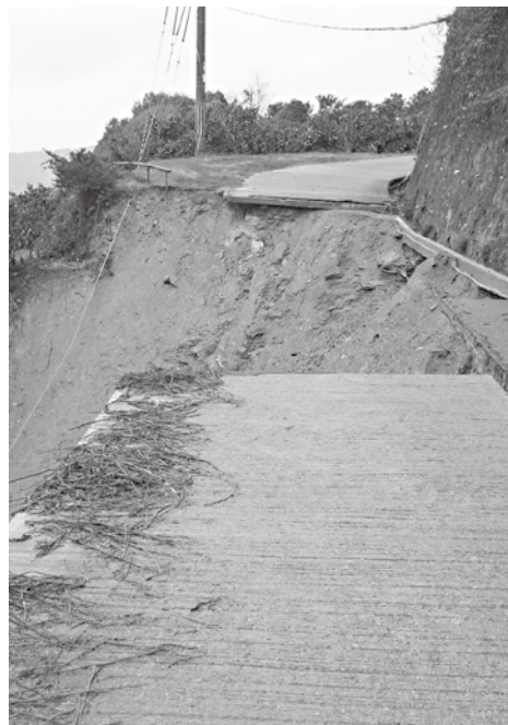
笠畑地区の農道の崩落現場
