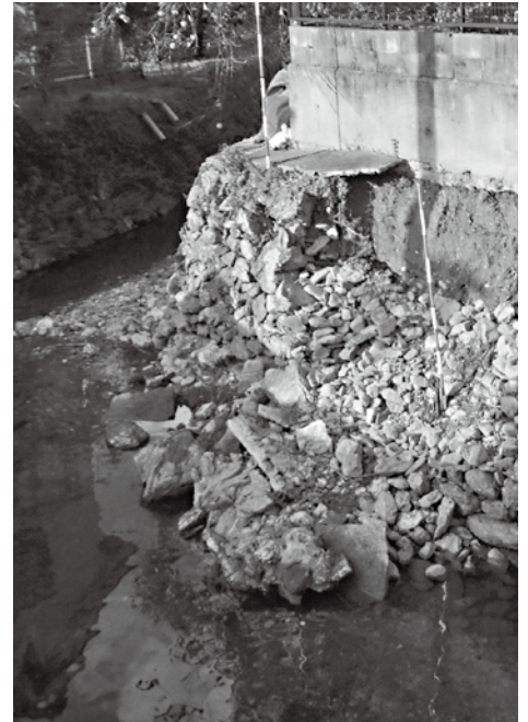
石積み護岸が崩れた薬師谷川
