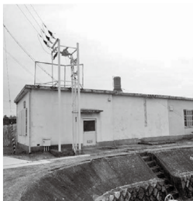
老朽化した導水ポンプ施設
