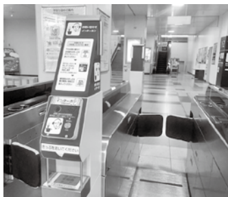
改札に設置されたインターホン
